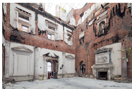
图6：大理石厅，克兰顿公园。火灾对其内部空间造成了巨大的影响
