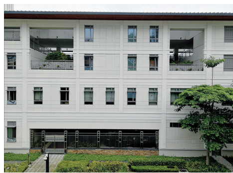
图10: 某庭院式公共建筑立面上的孔洞
