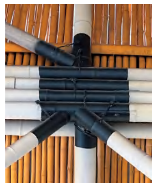
图 19：刷色后的竹节点。因 2023 年保护修缮后没有原样复原所有节点，此处仅说明刷色前后的差异，而不说明节点交接的变化。2023 年摄
